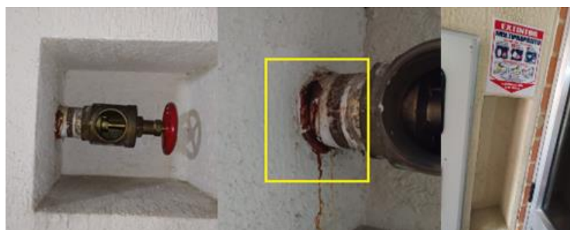
Imagen 7. Gabinetes al interior de los edificios.
