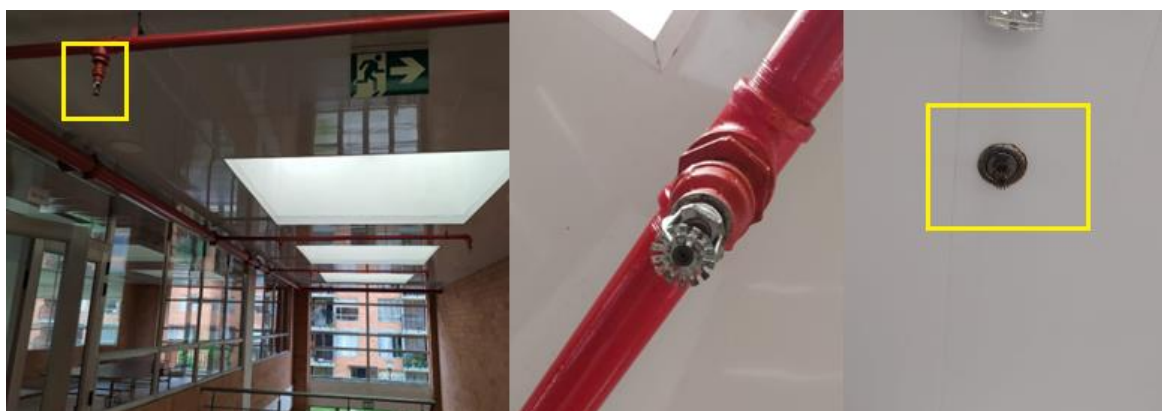
Imagen 5. Rociadores instalados, algunos con presencia de oxido.
