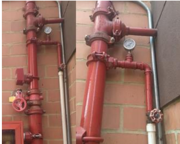
Imagen 8. Sistema de control RISER sin presión, no se observa válvula cheque.
