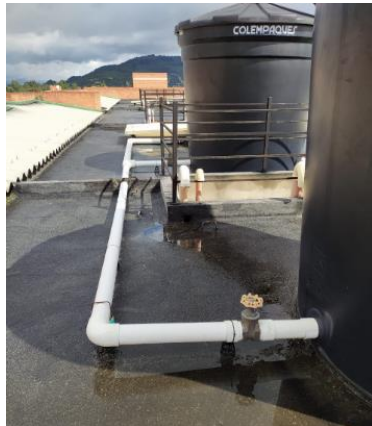
Imagen 2. Tanques de almacenamiento.
