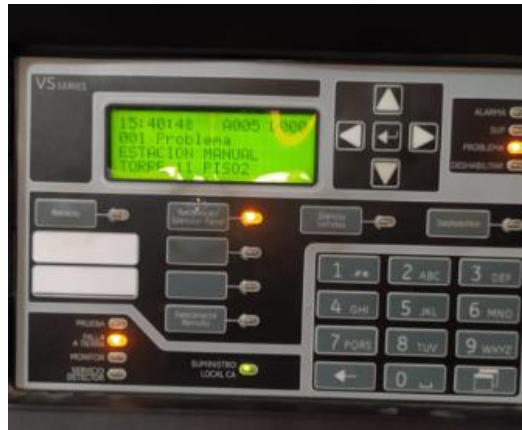
Imagen 3. Panel de alarma activado (TROUBLE).
