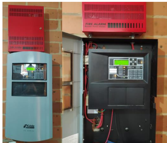
Imagen 9. Panel de control VIGILANT.
